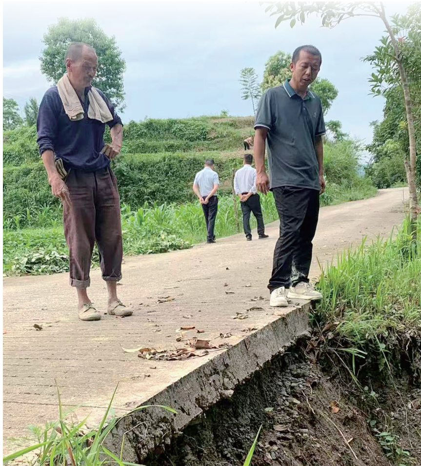
张治军（右一）查看垮塌公路偏坡。
