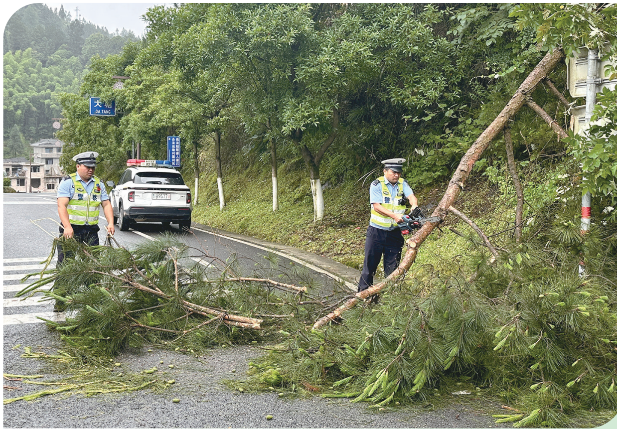
近日,受降雨影响,G243国道大塘镇路段出现树木倒伏、山体滑坡,道路通行受阻。雷山县公安局交警大队民警辅警巡查发现险情后,第一时间布设警戒标识,引导车辆绕行避险,现场清理路障并上报情况,联动相关部门协同处置,全力保障群众出行安全。
